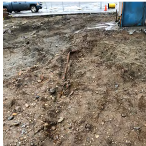
Photo 2: Exposed conduit beneath slab.
