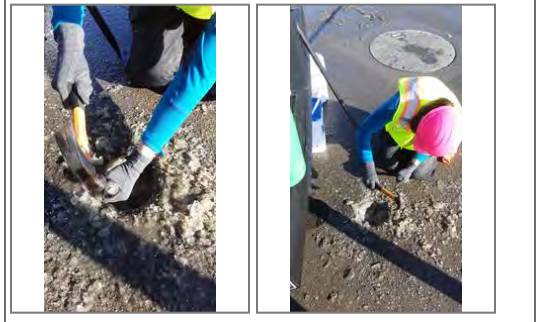
Purge water disposal: Pour on ground
