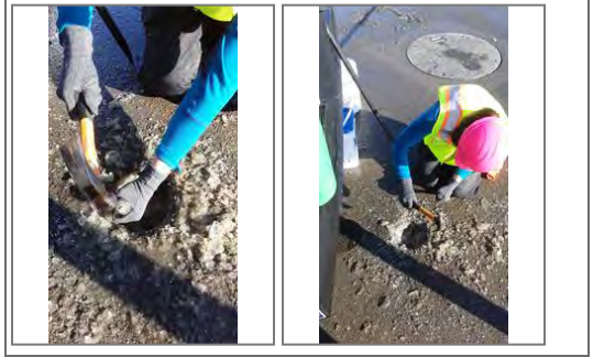
Purge water disposal: Pour on ground
